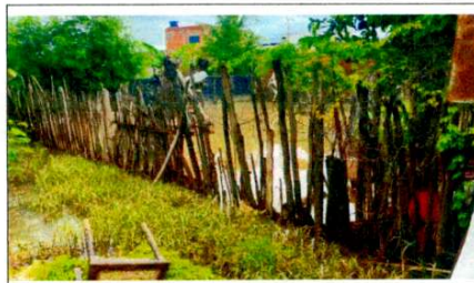
Figura 8 – Fundos do lote: cercamento em estacas de madeira e nível d'água elevado na área de quintal
