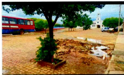
Figura 4 – Alagamento na Rua da Igreja e destruição do pavimento após chuvas de fev/2025 – Igreja ao fundo
