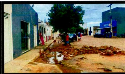
Figura 5 – Pavimento destruído e acúmulo d'água persistente – Mercado Jr. Soares ao fundo
